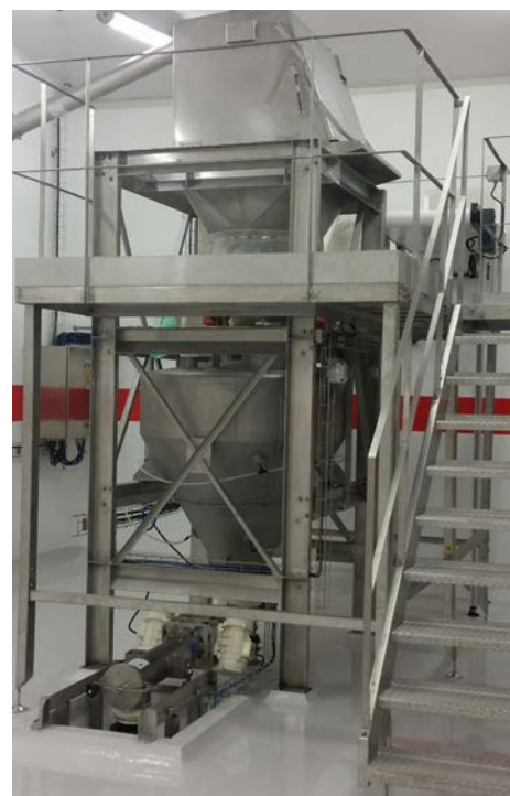
Station de tamisage et d'alimentation mélangeur
