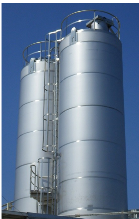
Silo de stockage
