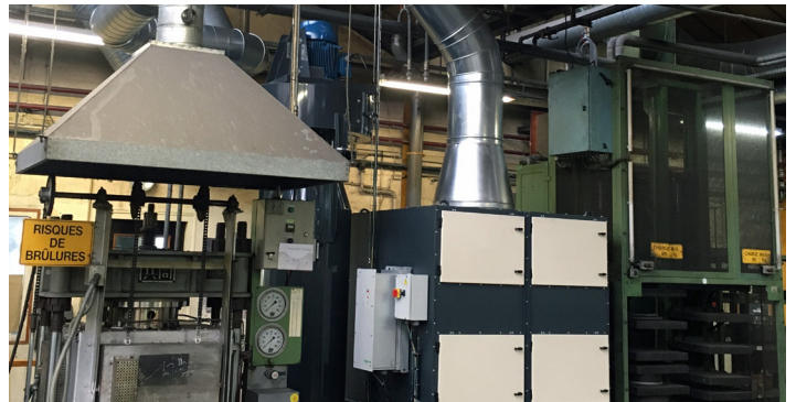
Extractie van metalen deeltjes van een sinterpers. Filtratie d.m.v. een FILTRACLEAN ECO
